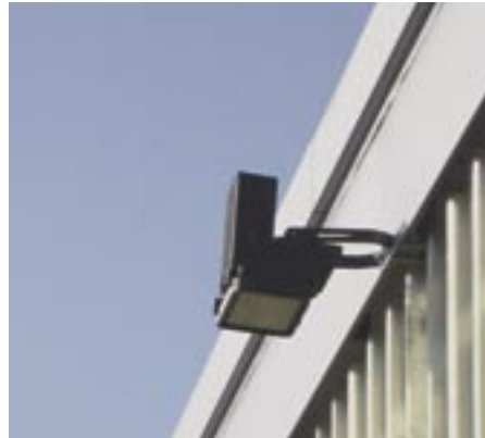
Soluzione ideale: l'illuminazione è parte integrante della facciata (con la luce orientata dall' alto verso il basso ).
