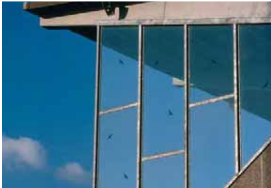
Windschutzverglasung mit praktisch wirkungsloser Markierung mittels Greifvogelsilhouetten
