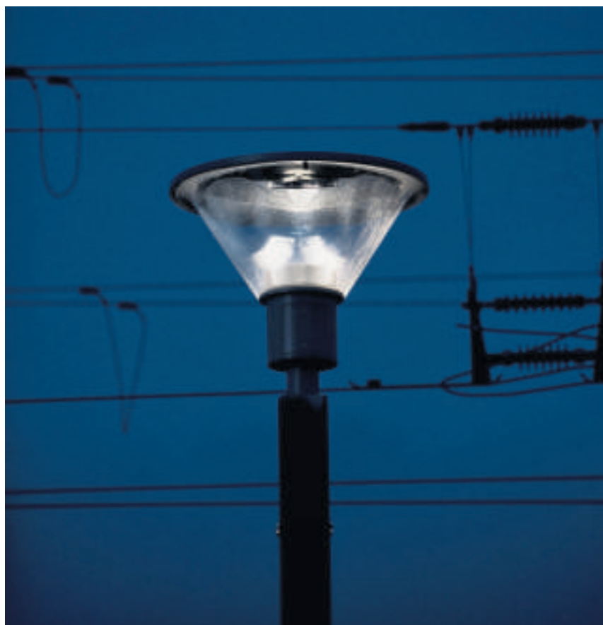
Dezenter als die bemängelten Leuchten: freistehender SBB-Kandelaber. KARIN HOFER / NZZ
