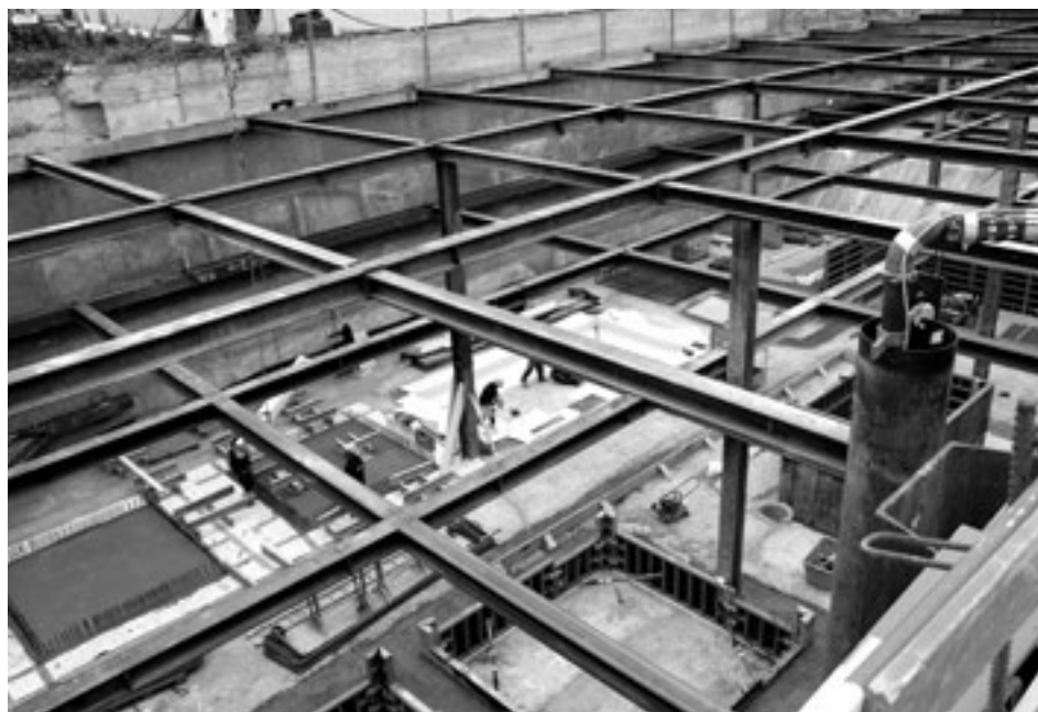
Was man später nicht mehr sieht: Viel Tiefbau unter neuen Wohnhäusern an der Alderstrasse. Foto: Adolf Gucker, 2015
