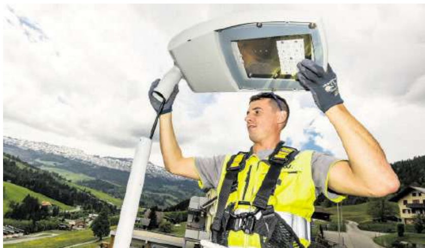
Die Gemeinde Flüfli hat alle Strassenlampen auf LED umgerüstet. CKW
